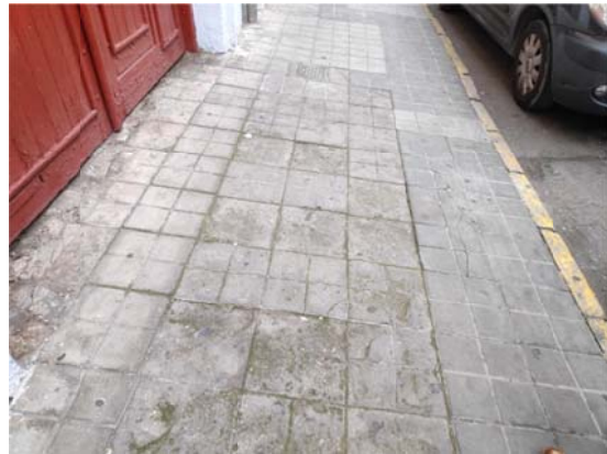
Foto 2: Estado general acerao derecho
