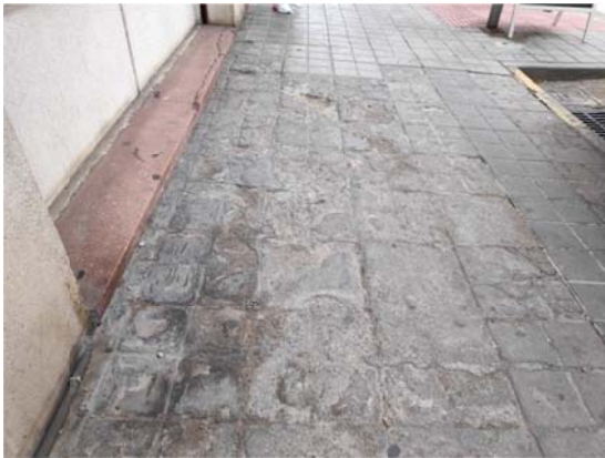
Foto 1: Pavimento baldosas muy desgastado
