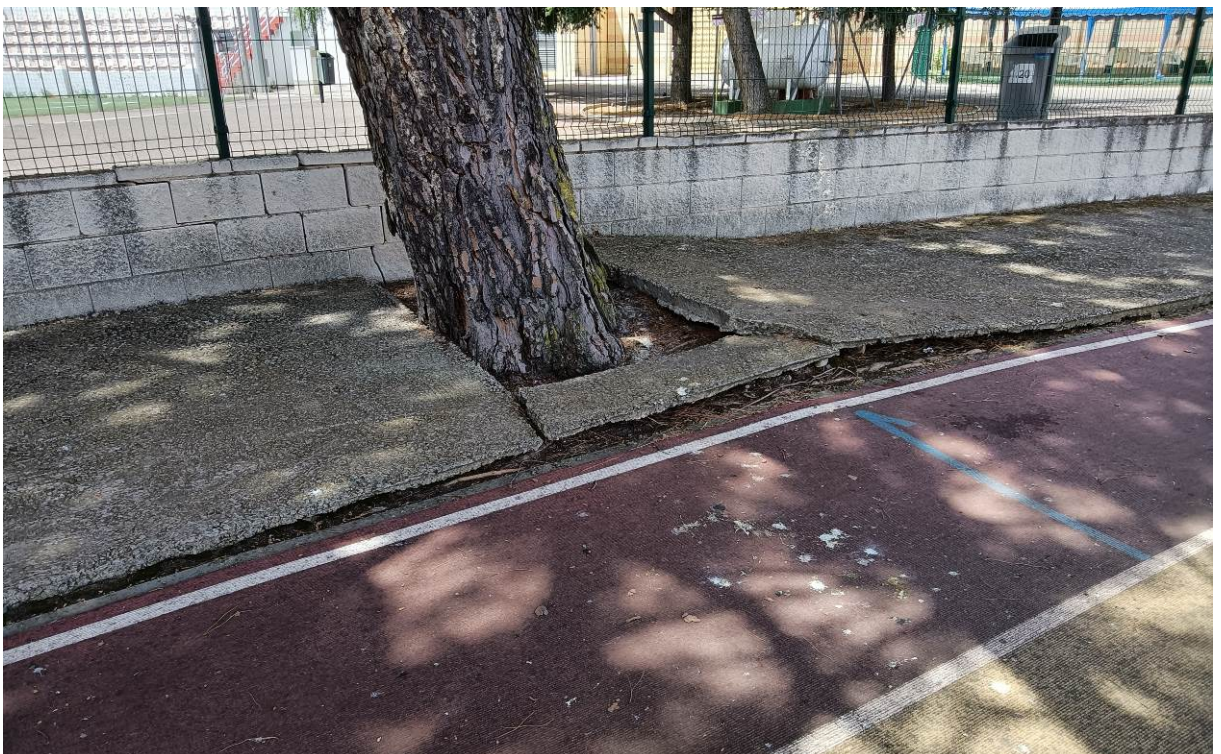
Estado actual del anillo perimetral de hormigón. Abombamientos pista de atletismo.
