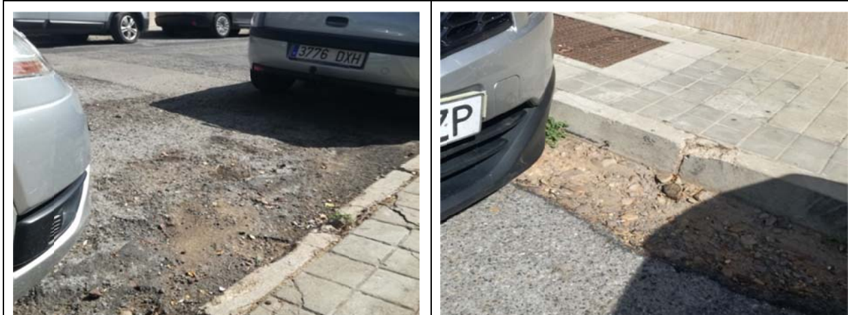
Estado firme: calzada cuarteada, con reposiciones de firme y zonas descarnadas
